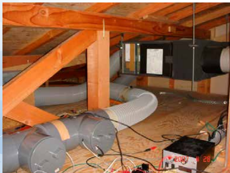
図1 計画換気システムダクトの能動騒音制御実験
