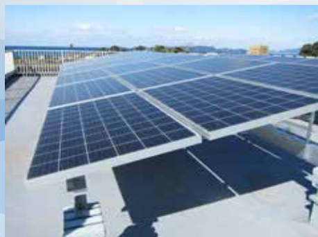
図1 鹿児島県長島町に設置した太陽光パネル
